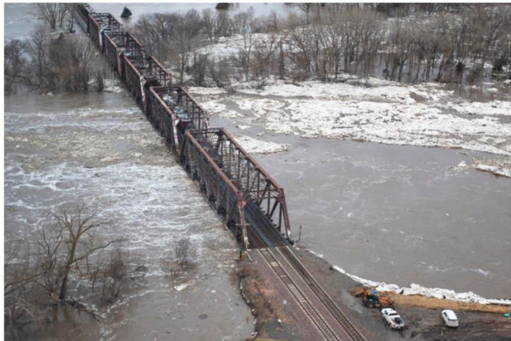
Figura 2-9: Puente Ferroviario Inundado
