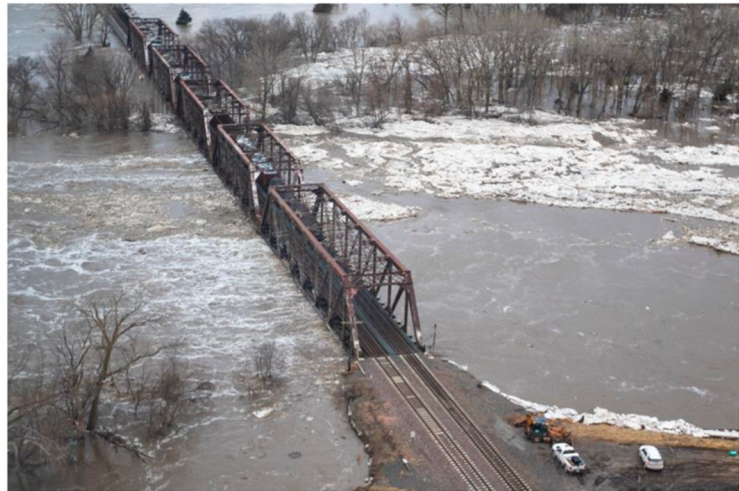
Figura 2-9: Puente Ferroviario Inundado
