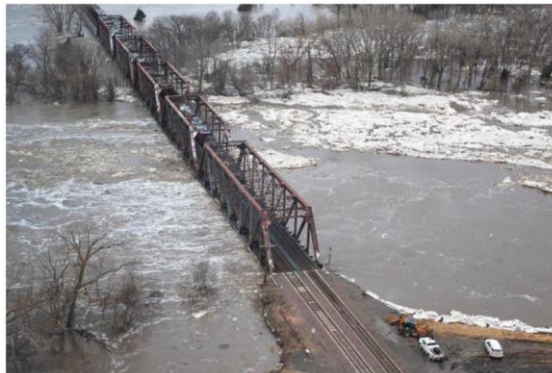
Figura 2-9: Puente Ferroviario Inundado
